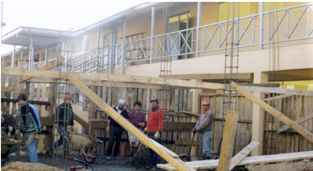
Figura 12.7: Desde la entrada principal hacia la esquina de Oñederra con Montt, el edificio ya terminado. En construcción, sector de biblioteca (por eje de calle Montt, año 1997).
